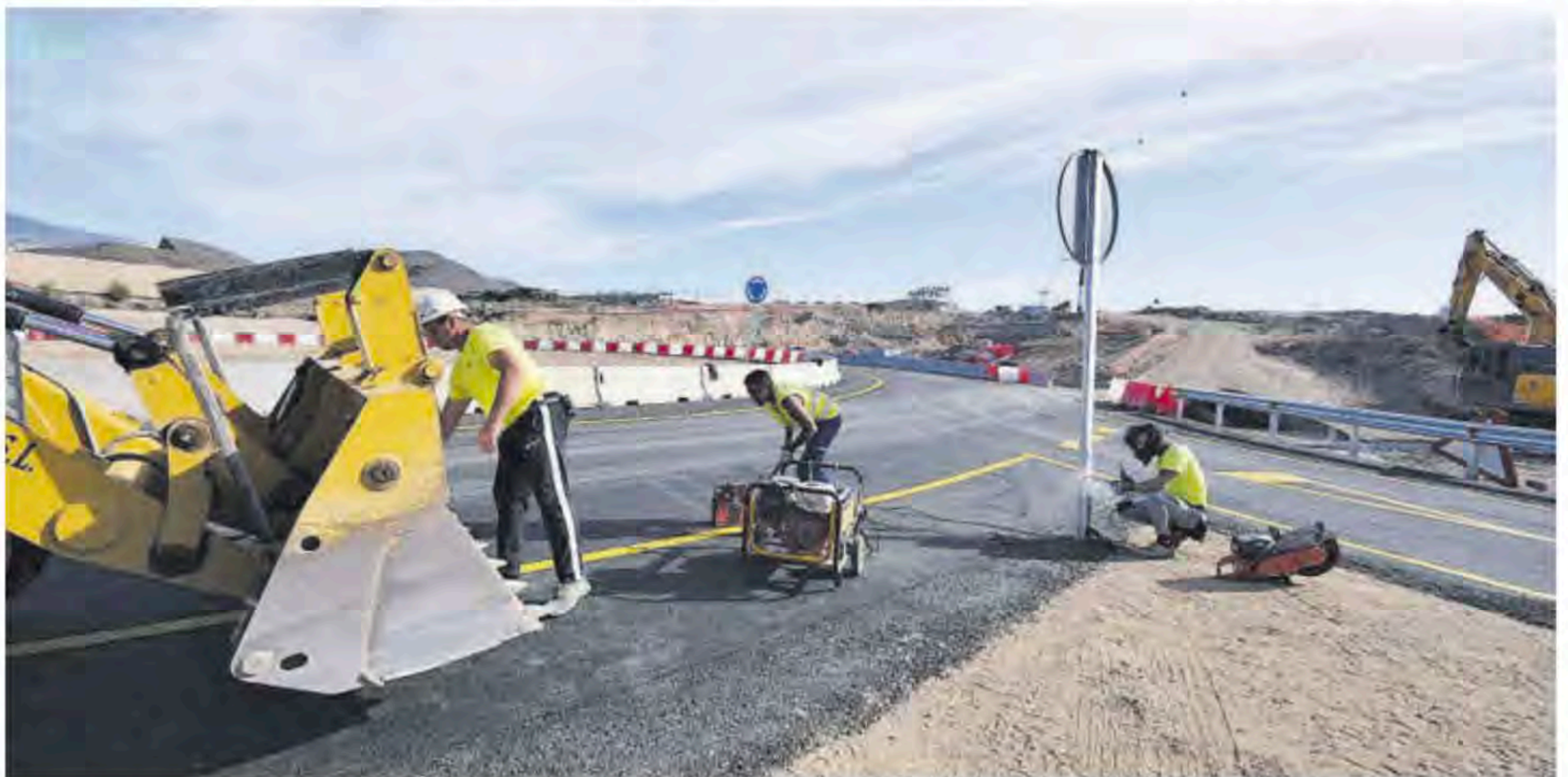
Obra de remodelación en la carretera de los enlaces de Las Chafiras y Oroteanda, en Tenerife. DELIA PADRÓN
